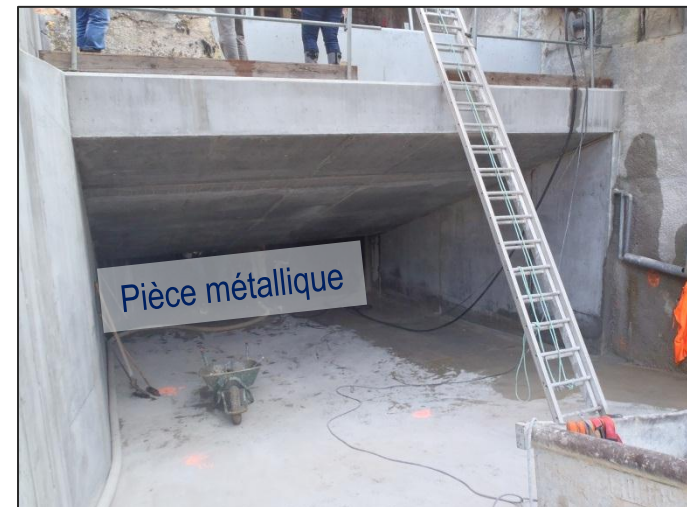
Sortie de l'aspirateur en BA (partie aval) 29/09/11
